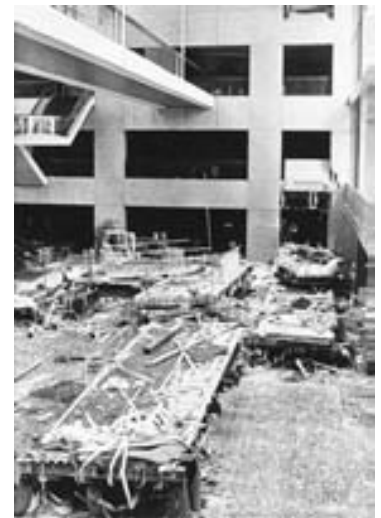
FIGURA 12-1 Un piso elevado se colapsa en un hotel de Kansas City en 1981. En el ejemplo 12-9 se considera cómo un sencillo cálculo de física pudo haber prevenido la trágica pérdida de más de 100 vidas.
