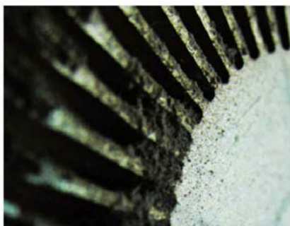
↑ Ventilador con exceso de polvo.
