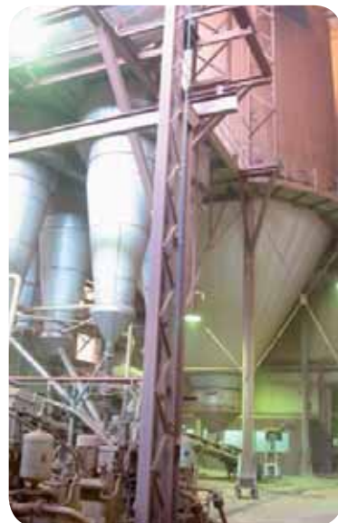
FOTOGRAFÍA 1.7. Vista general de un secadero por atomización.
