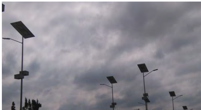
Fig. VI.9. Instalaciones para aprovechar energía solar en Colombia.
