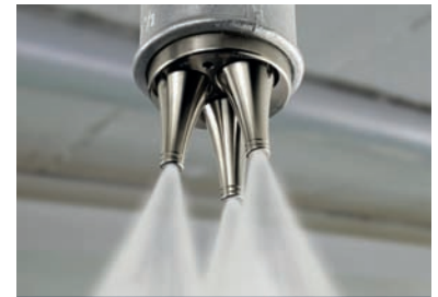
2.4. Dispositivo de agua nebulizada para extinción de incendios.
