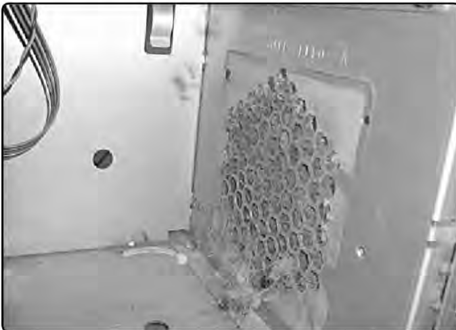
FIGURA 2. Entrada de aire de un gabinete obstruida por polvo y pelusas. Demás está decir que es necesario limpiarla.
