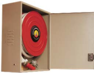
Boca de incendio equipada de 25 mm + toma adicional de 45 mm
