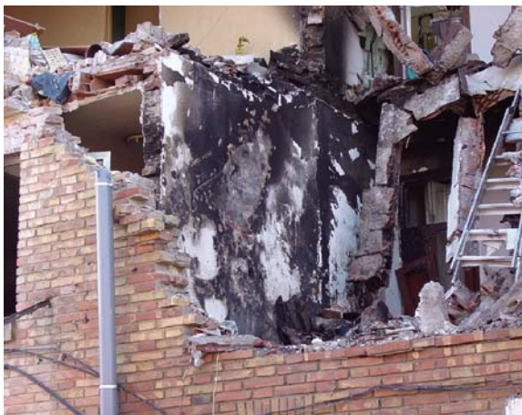
En esta explosión por deflagración sí hubo efectos térmicos por incendio posterior.
