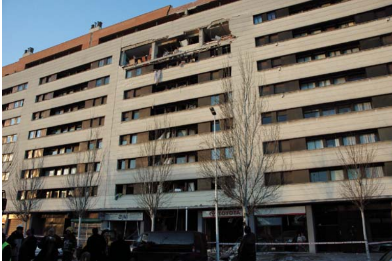
Las partes más débiles de la estructura del edificio son las que ceden aliviando la onda de sobrepresión en una deflagración.
