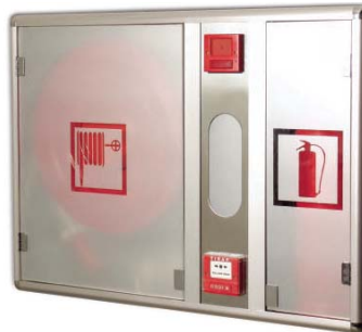
Boca de incendio equipada de 25 mm + módulo para extintor + módulo para sirena + pulsador y luz de emergencia (empotrada)
