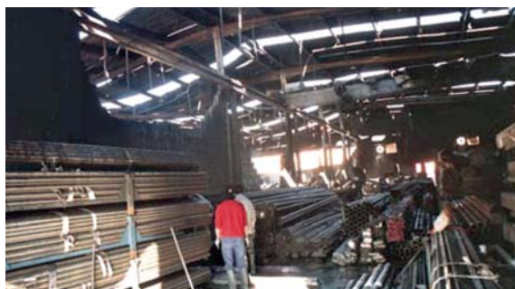
Nave industrial donde los muros de compartimentación disponían de una mala resistencia al fuego, a pesar de que la cubierta no colapsó
