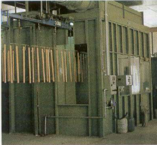
Sistema transportador de piezas en la entrada de un túnel secadero.
