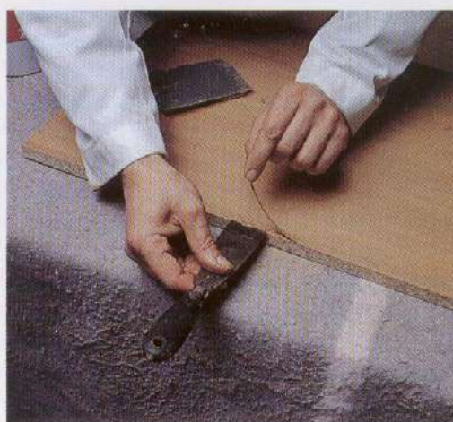
Reparación mediante encolado de una pequeña tira de chapa suelta en el borde de la pieza.
