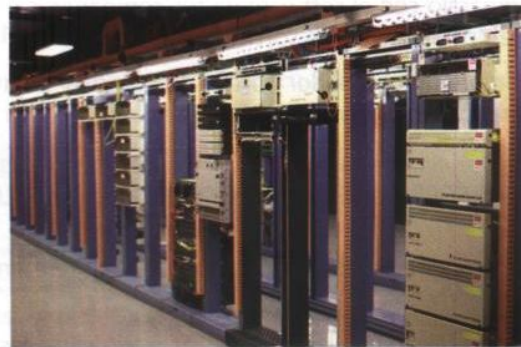
↑ Racks dentro de un data center en San Antonio, Texas.
